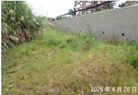
洗掘4（旧道路の洗掘を造成に併せて整備）
