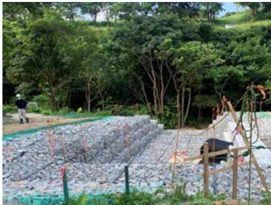
崩落1（旧排水路流末。対策整備後の状況）
