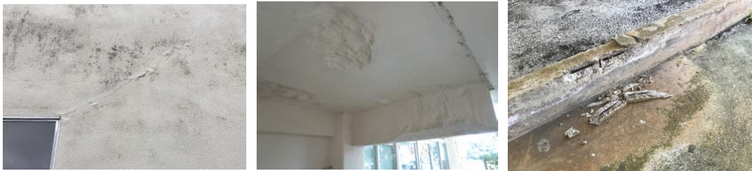
▲ひび割れや剥落が見られる (左:第1庁舎外壁 中:第1庁舎階段裏 右:第2庁舎外階段下)
