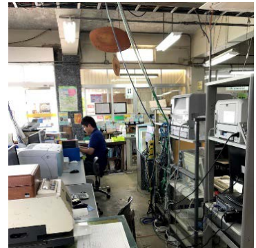
▲ 現在の OA 機器類の配線の様子 柔軟な配置が難しい状況となっている （第 1 庁舎執務室）
