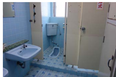
▲段差があり、また狭く、誰でも利用しやすいデザインとなっていない（第1庁舎 女子トイレ）
