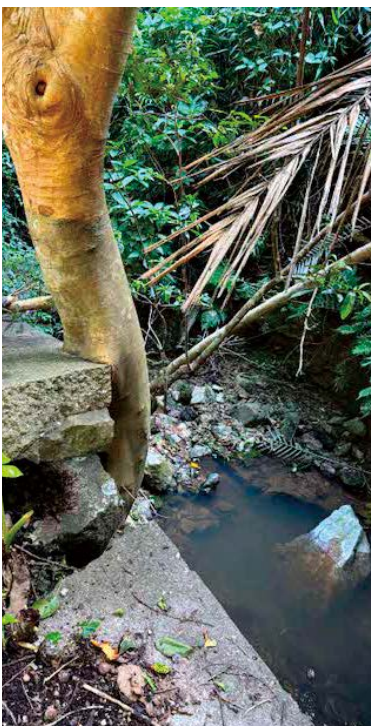
用水路の擁壁が損壊している
