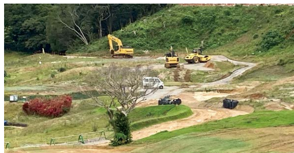
旧嵐山ゴルフ場跡地に沖縄北部テーマパーク建設工事が急ピッチで進められている。
