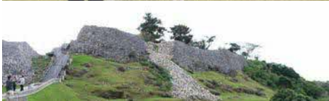
今帰仁城跡城壁崩落現場
