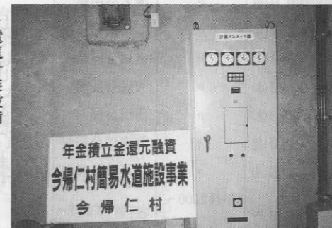
▶電気計装設備
